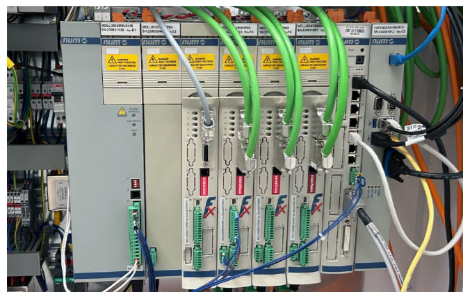
Innenraum des Schaltschranks
